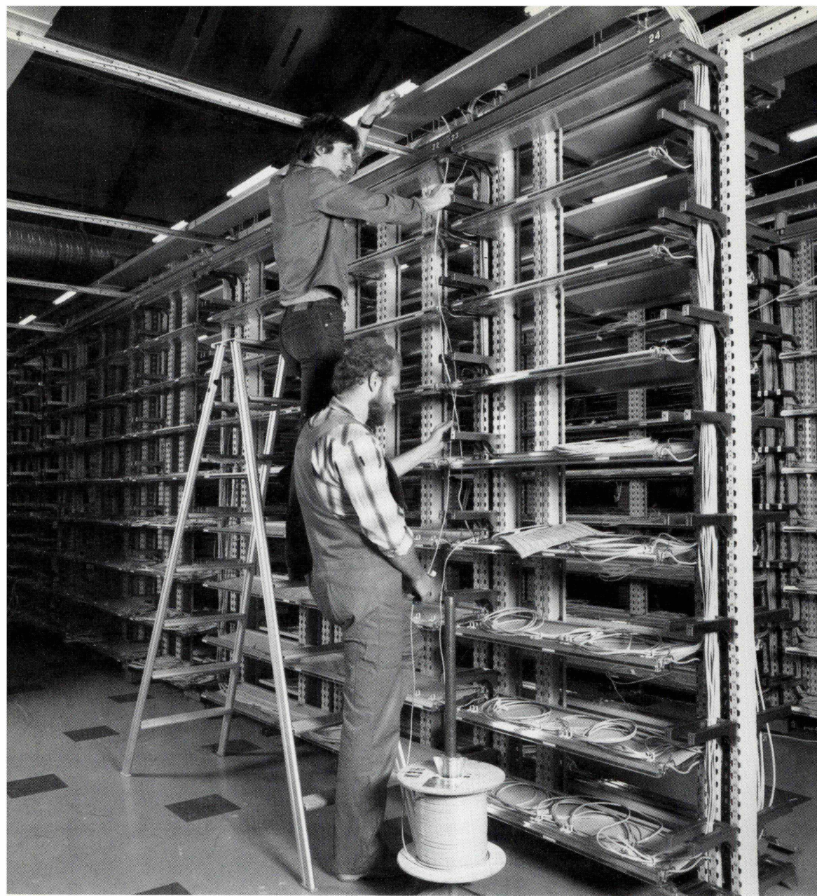
1. Kabeldragning i AXE-stativ, 1980-talet. L M Ericssons fotoarkiv.
